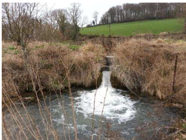
Image 14 : la chute de cet ouvrage bloque la dynamique du cours d'eau et maintient cet ensasement.
