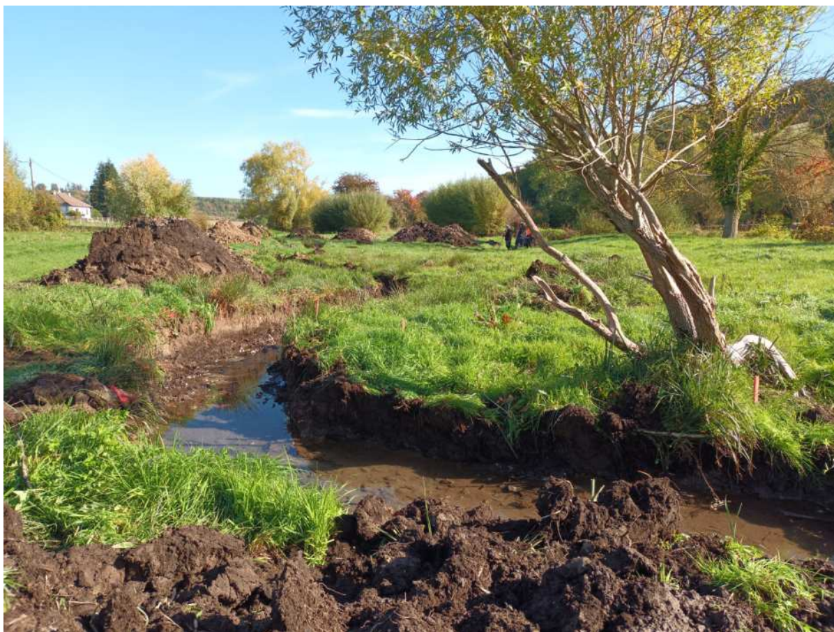
Image 45 : des affouillements moins profonds sur ce secteur.
